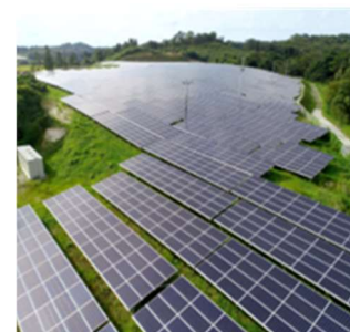
● 太陽光発電所
