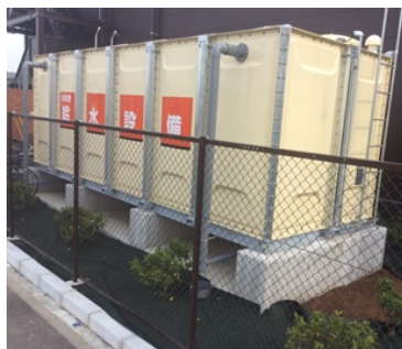
非常用給水設備
