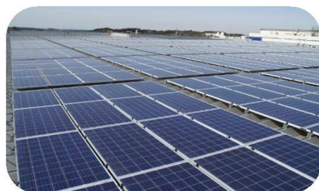
【当社太陽光発電設備】
