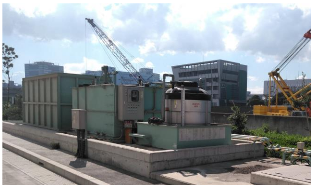
排水処理プラント(横浜恵比須リサイクルセンター)
