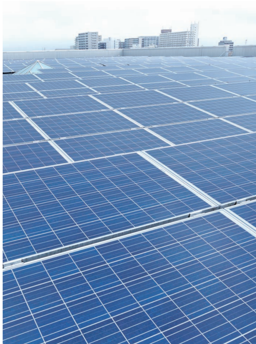
滋賀工場の屋上に設置された太陽光パネル
