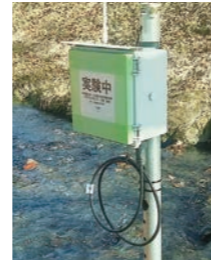
写真の水位計(河川の水位監視)に汎用送信基板が使用されています。
