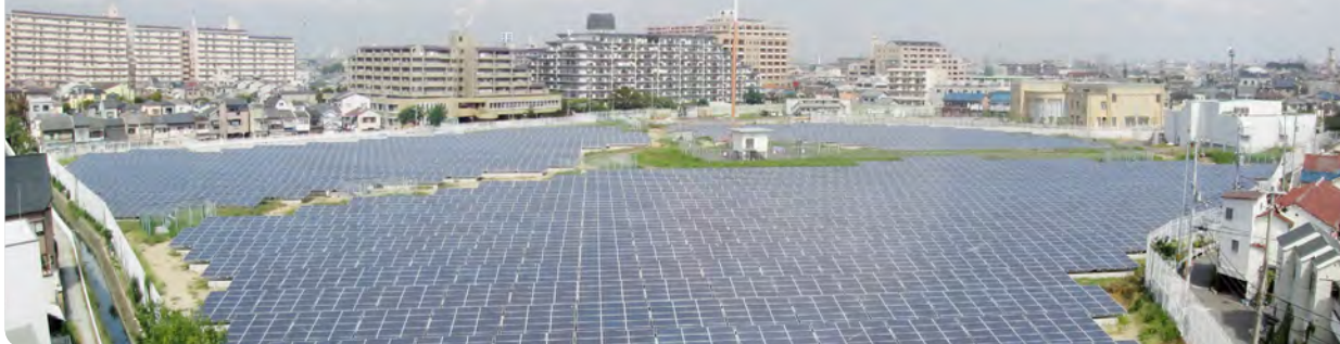
高石ラジオ送信所に設置された太陽光パネル
