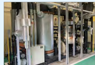
茨城工場のバイオマスボイラー
