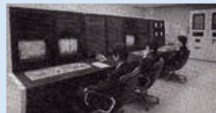
当時の新宿野村ビル防災センター
