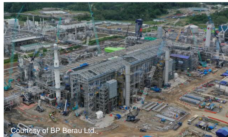
*1 インドネシア・タングーLNG
