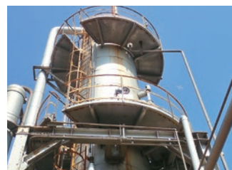
改造した濃縮分離施設
