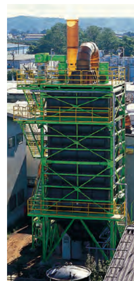
排ガス処理設備
