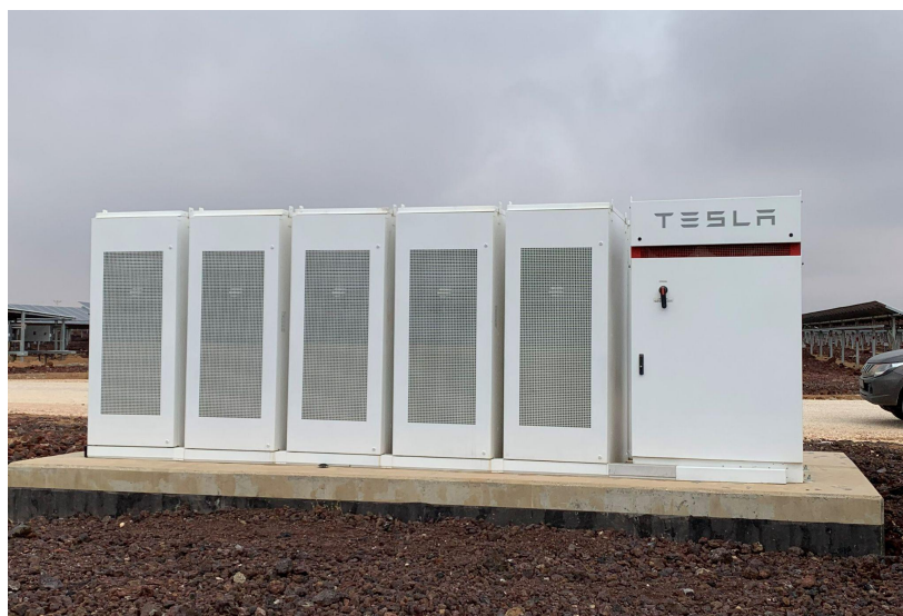
サイトに設置されているTesla社製の蓄電池
