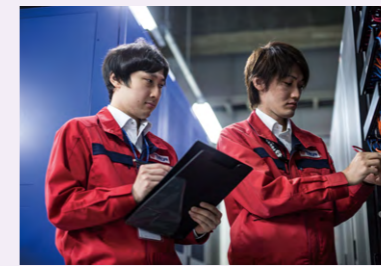
アット東京のデータセンター
