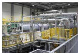
10MW級アルカリ水電解システム
