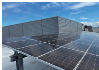
19kWの太陽光発電
