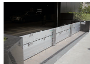
東京本社 浸水対策「止水板」
