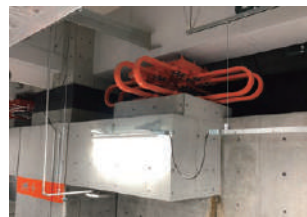
プラネット南関東 免震装置
