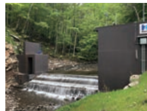
群馬県利根郡 川場合小水力発電所
