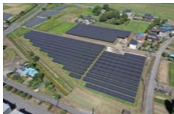
太陽光発電設備(埼玉県加須市)
