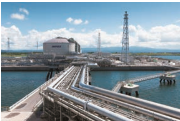
直江津LNG基地
