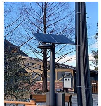
脱炭素社会の実現に向けて太陽光パネルや蓄電ソーラー外灯も設置
