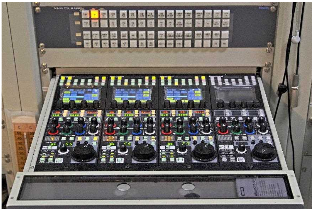
コントロールパネル「OCP-300」 4 式
