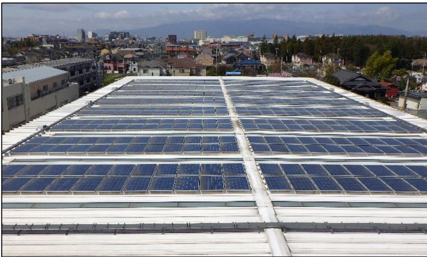
太陽光パネル（サガミ工場）
