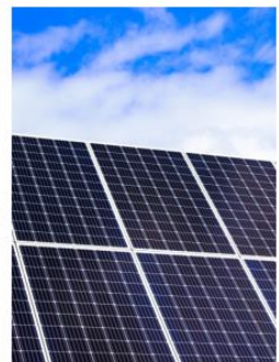
太陽光発電所
