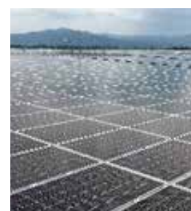
イオンモール津南の太陽光パネル
