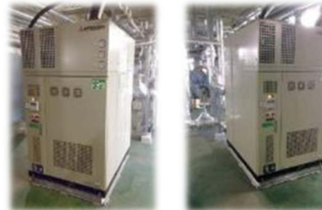
■ 消化槽の熱回収(ヒートポンプ)
