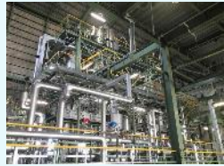
CO 2 原料の メタノール製造技術
