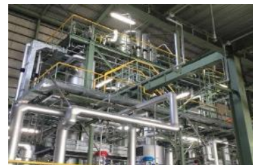
環境循環型メタノール検討用 パイロットプラント
