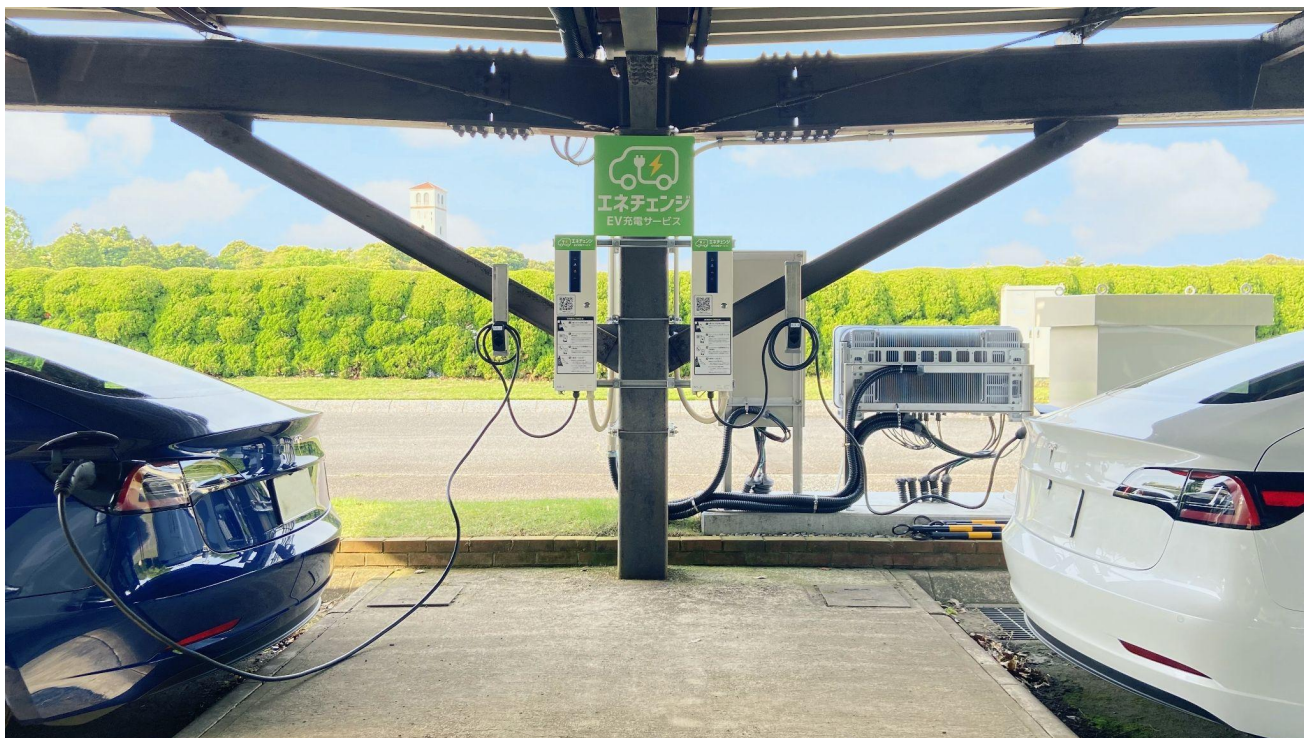
米原ゴルフ倶楽部に設置されたエネチェンジEV充電サービスの充電スタンド
