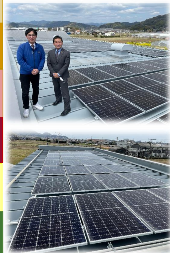
【自社倉庫屋上の太陽光パネル】
