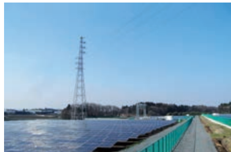
市貝太陽光発電所
