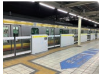
ホームドア(南武線武蔵小杉駅)
