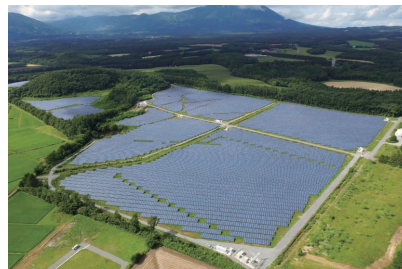
雫石太陽光発電所（岩手県）
