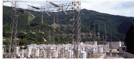
新佐久間周波数変換所等増強工事（写真は現佐久間周波数変換所（静岡県）
