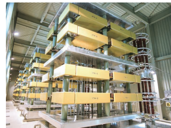
佐久間周波数変換所 (既設・静岡県)
