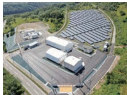
甲府市米倉山の電力貯蔵技術研究サイトにおいてPower to Gasシステムを構築
