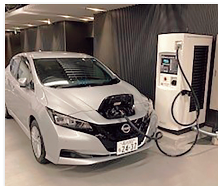
急速EV充電器
