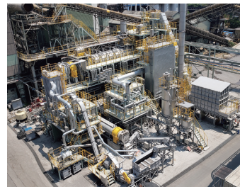
低温加熱脆化技術による処理困難プラスチックのリサイクル施設
