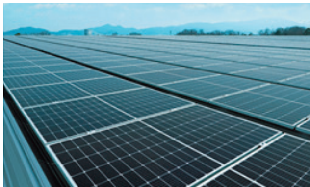
太陽光発電設備
