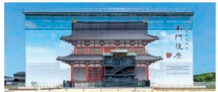
施工中は、南門を風雨から守る鉄骨造の素屋根を設置(手前の階段のある部分が見学デッキ)
