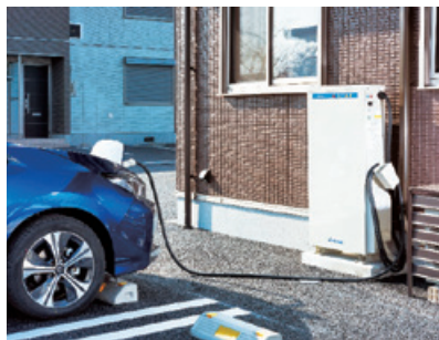
V2Hスタンドを設置、電気自動車への充電や建物内への給電も可能
