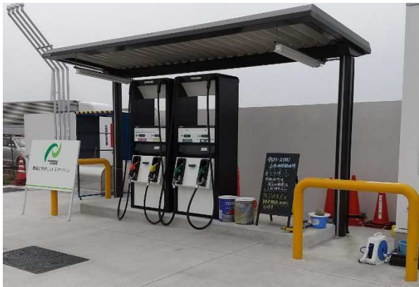
名港潮見給油所
