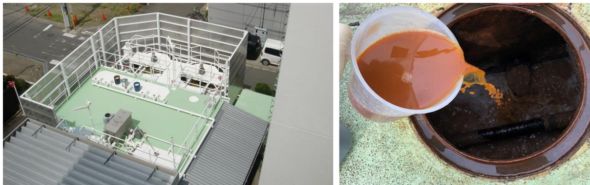
相模化成工業株式会社が所有する廃水処理設備（左）と、処理槽へ片岡バイオの微生物群を投入する様子（右）
