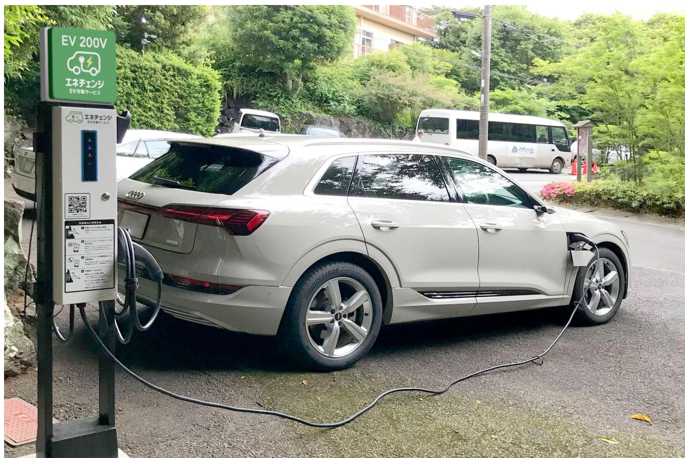
坐漁荘の駐車場に設置されたエネチェンジEV充電サービスの充電スタンド
