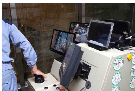
ごみクレーン操作室のモニター
