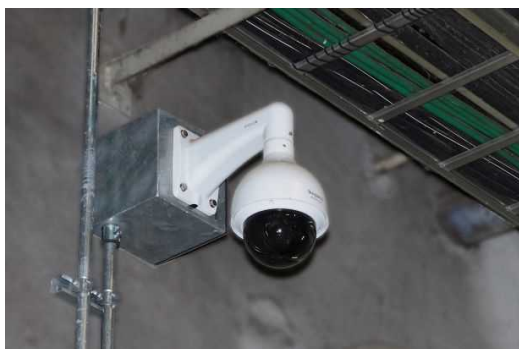
作業エリア、出入口に設置された ドームカメラ
