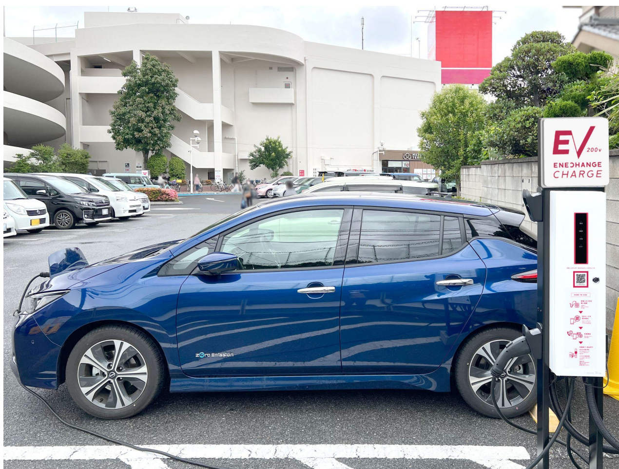
マツバラテラスに設置されたエネチェンジEVチャージの充電スタンド
