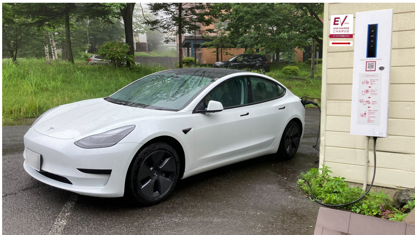
「草津温泉宿 永田屋」に設置されたエネチェンジEVチャージの充電スタンド
