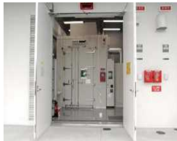
充放電試験用の恒温恒湿室
