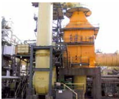
COボイラー排煙脱硝装置
