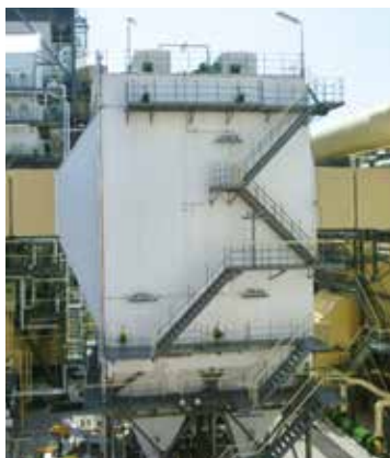
10号ボイラー発電所の 乾式電気集塵機
