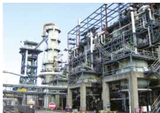
減圧残油熱分解装置
