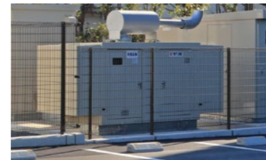
非常用発電機
