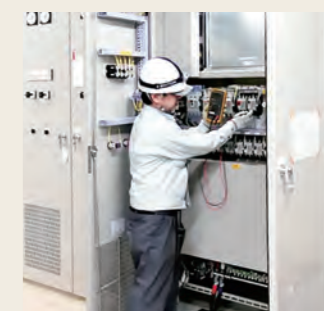
無停電電源装置の点検
