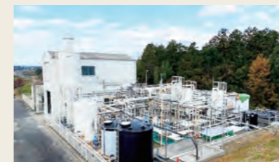
岡山工場の排水処理設備
