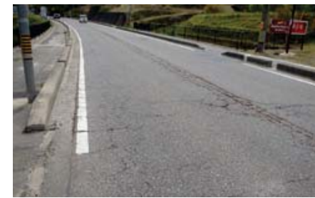
破損が進行した既設舗装
