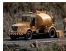
① 路上混合式工法で砂利道を舗装に変える「カチオゾール」
