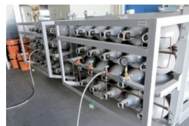
ポンベを連結したカードル設備
