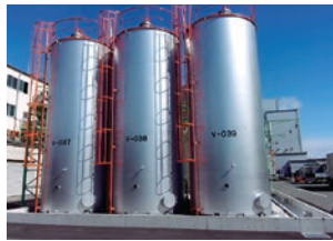
洗浄用苛性タンクと防液堤
