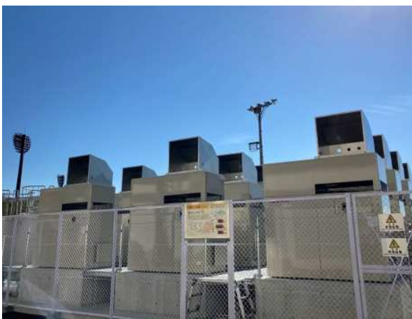
消化ガス発電設備
