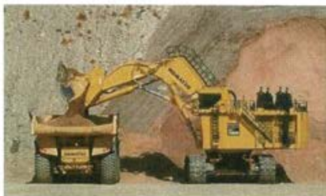
【無人専用運搬車両に積み込み作業を行う 超大型油圧ショベル PC7000-11】
